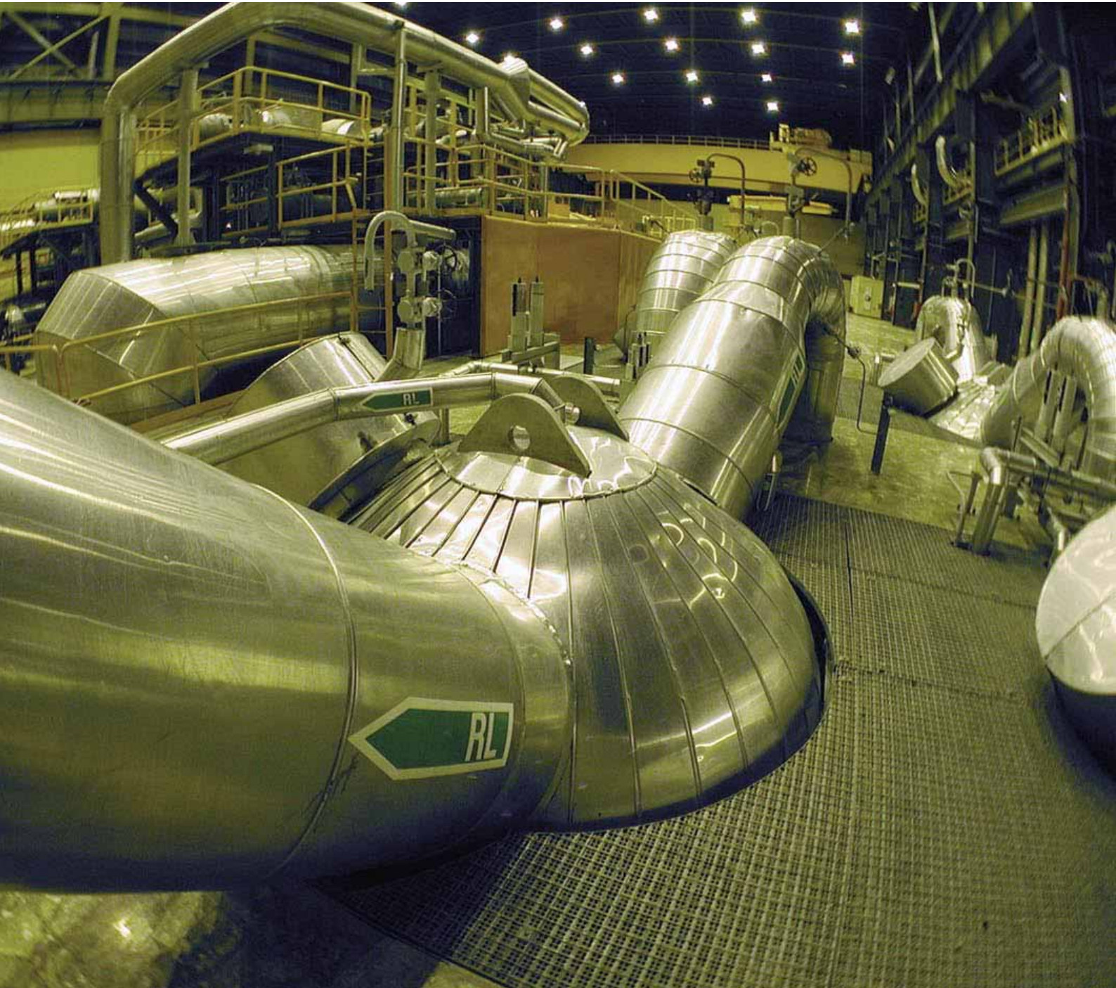
Edificio de turbina de una Central Nuclear
