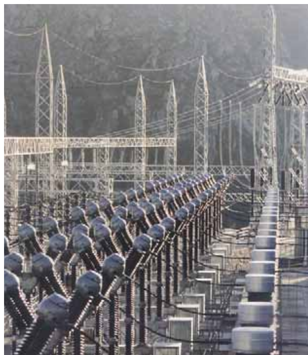
Parque eléctrico de una Central Nuclear
