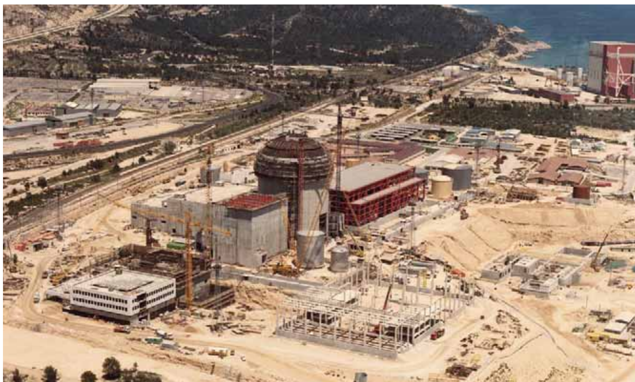
Construcción de la Central Nuclear de Vandellós II con vista de Vandellós I al fondo
